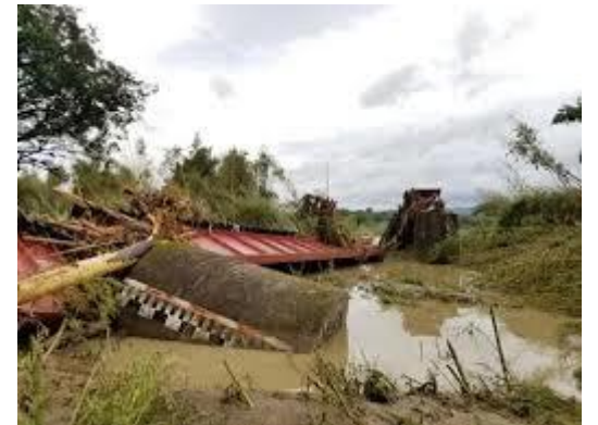
倒壊した橋梁
